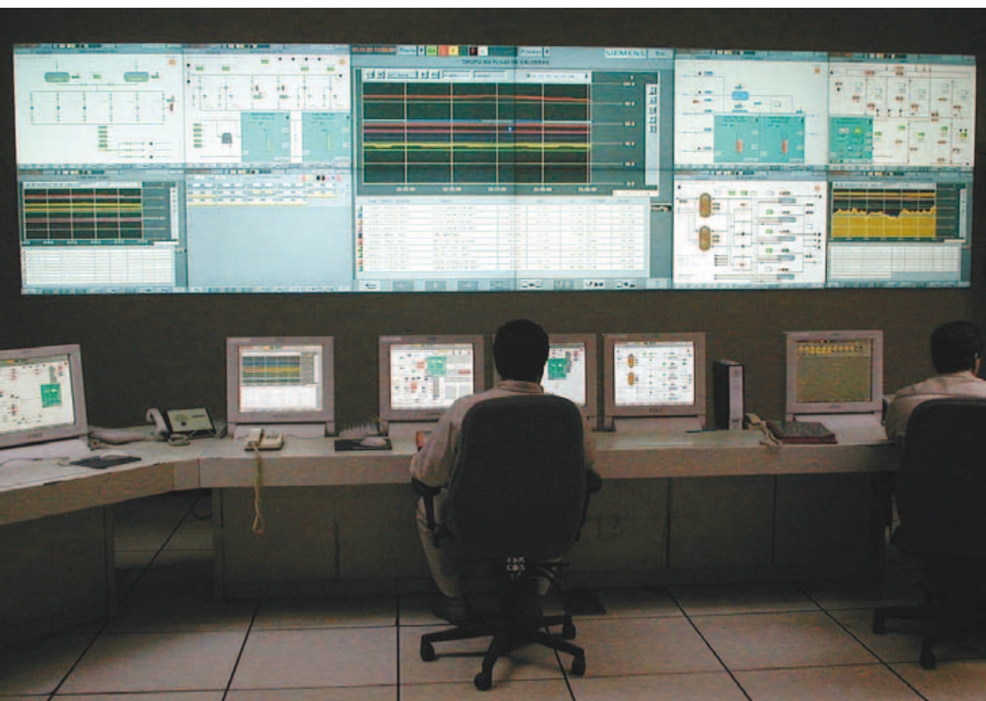
CUARTO DE CONTROL CENTRALIZADO, PEMEX
