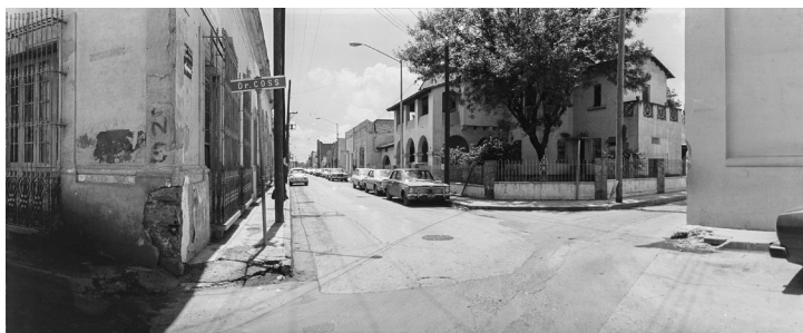
En los vértices inferiores de la propiedad en primer plano se observan claramente los desprendimientos del edificio por golpes de vehículos, lo mismo que en lado derecho de la fotografía que corresponde con un muro de la Catedral. Imagen 9. Fausto Tovar Martínez, Cruce de las calles Abasolo y Dr. Coss , Monterrey, Nuevo León, Ca. 1981. Procedencia: Fototeca Nuevo León-CONARTE © Fondo Fausto Tovar.
