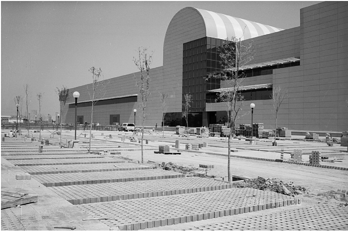
Imagen 18. Autor no identificado, estacionamiento de Cintermex durante su pavimentación , Monterrey, Nuevo León, ca. 1990. Procedencia: Fototeca Nuevo León-CONARTE © 63046 Fondo Fundidora.
